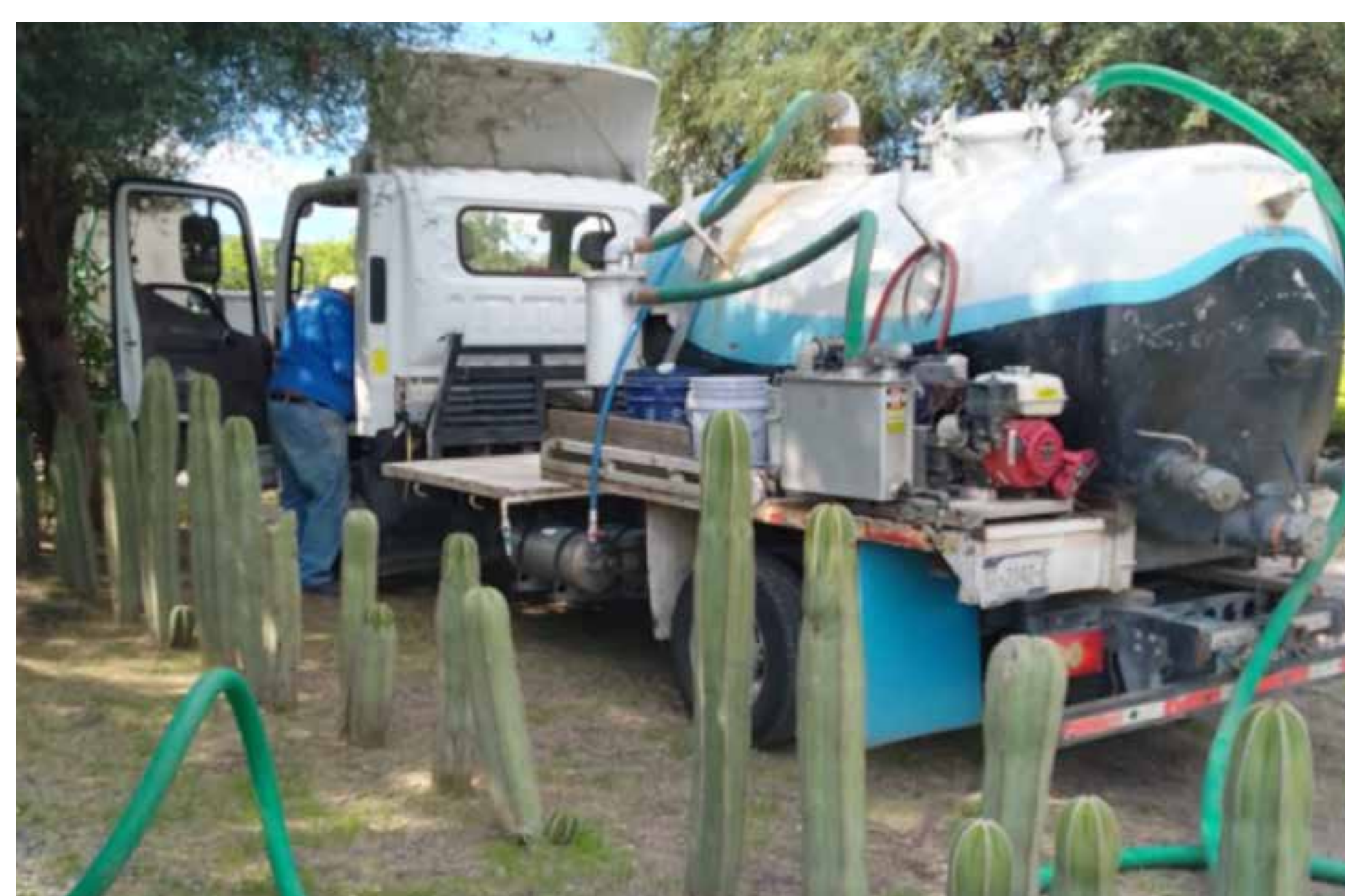
SUMINISTRO DE AGUA POTABLE Y VACIADO DE CISTERNA SANITARIA
